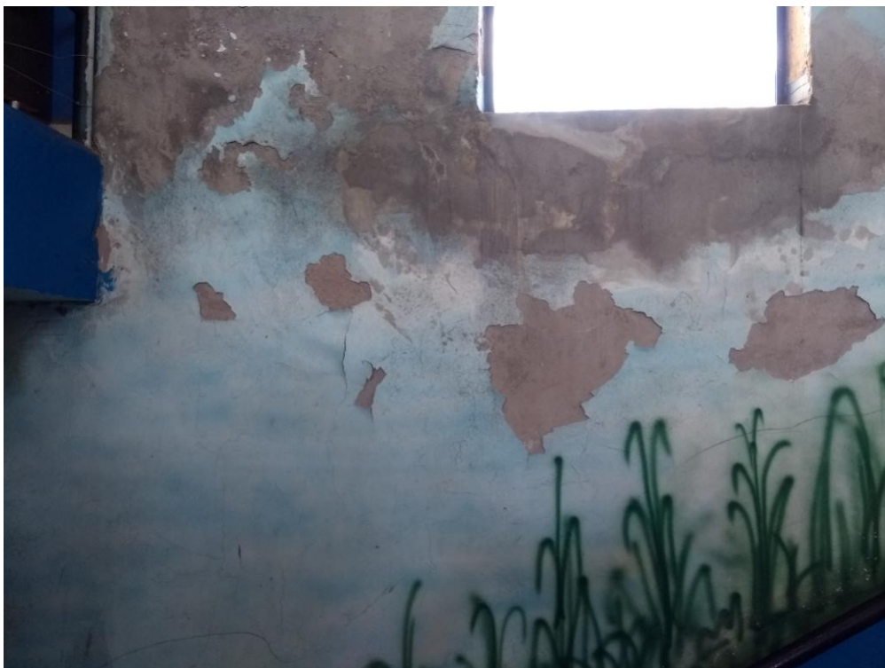
Exemplo de local onde o revestimento em argamassa em estado deteriorado deverá ser removido.
