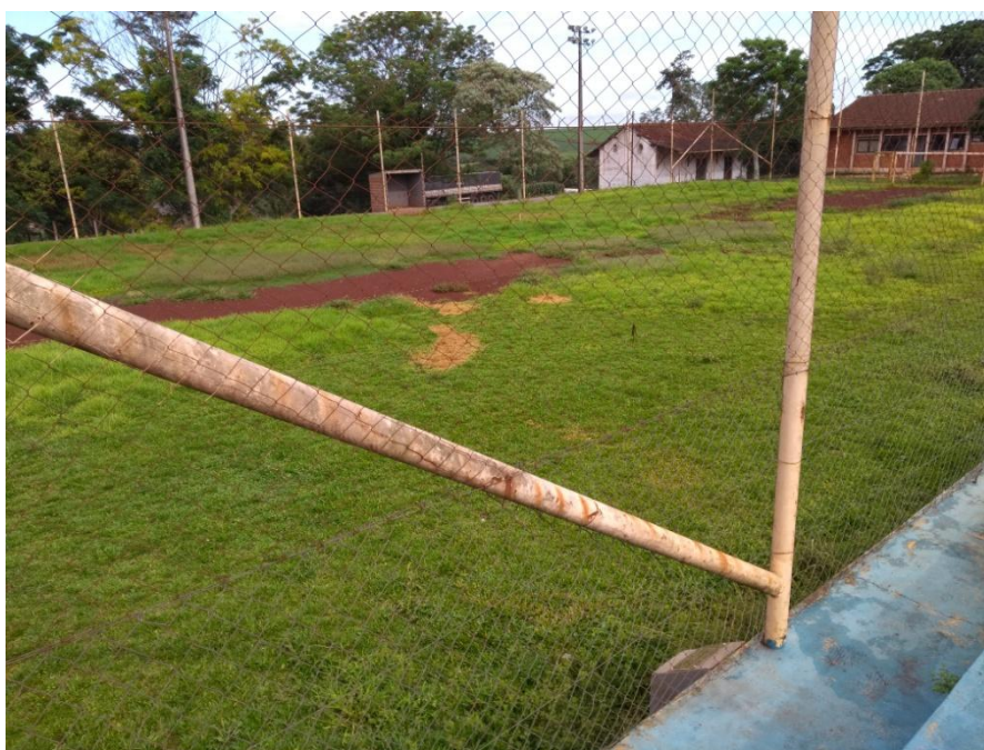
Postes metálicos do alambrado em que a pintura e a oxidação deverão ser removidas.
