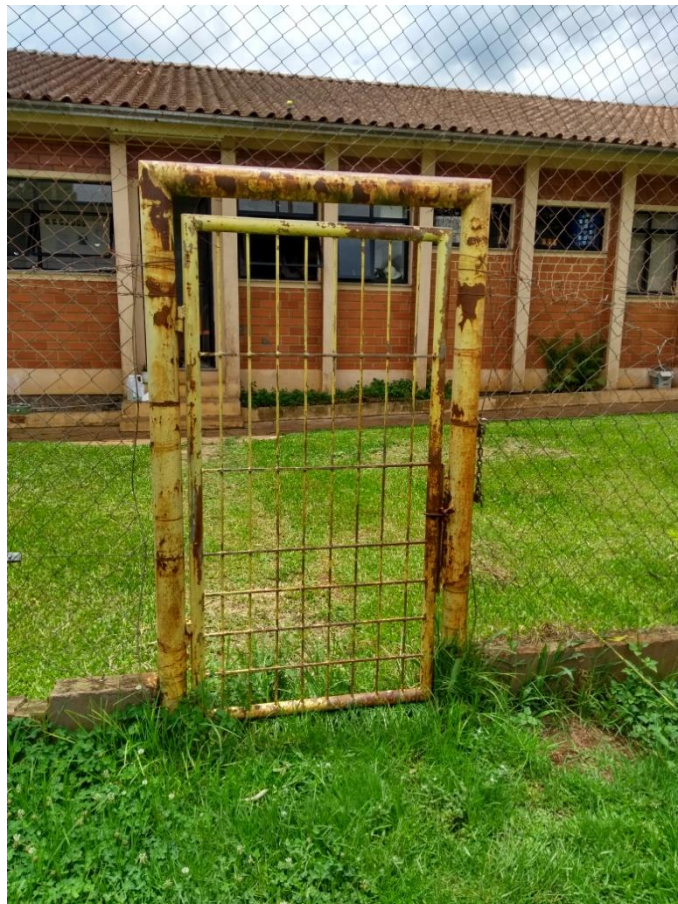
Portão secundário de acesso ao gramado pela linha de fundo em que a pintura e a oxidação deverão ser removidas.
